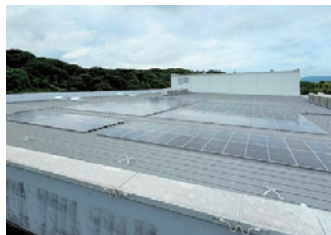
太陽光発電設備(広島工場)
