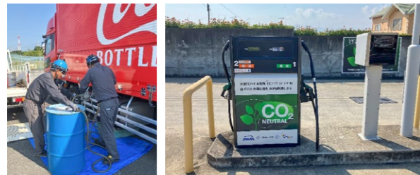
燃料切り替えにともなう軽油抜き取り作業の様子 リニューアブルディーゼル対応給油設備
